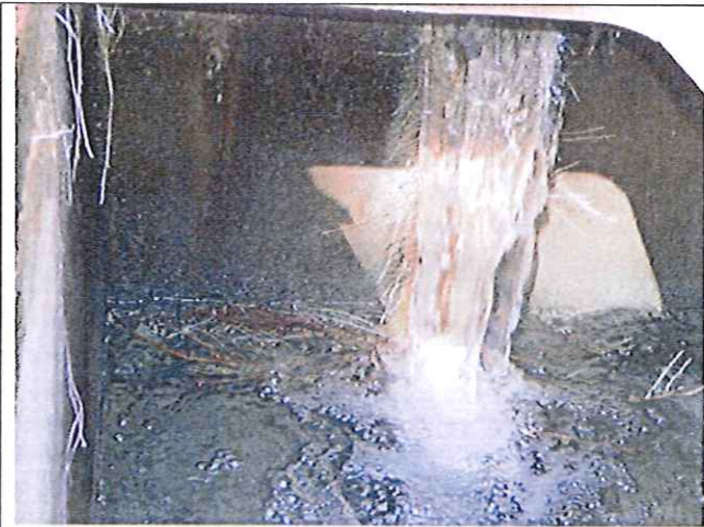
Photo 5 : Louvet, vue de l'intérieur du captage n° 4 avec la présence de queues de renard.
