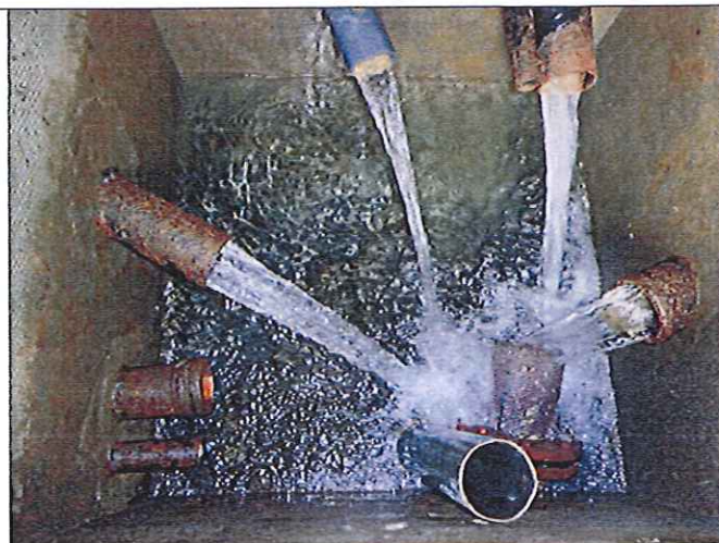
Photo 2 : Louvet, vue de l'intérieur du captage n°3 avec les arrivées des captages n° 1, 2, 4 et 5
