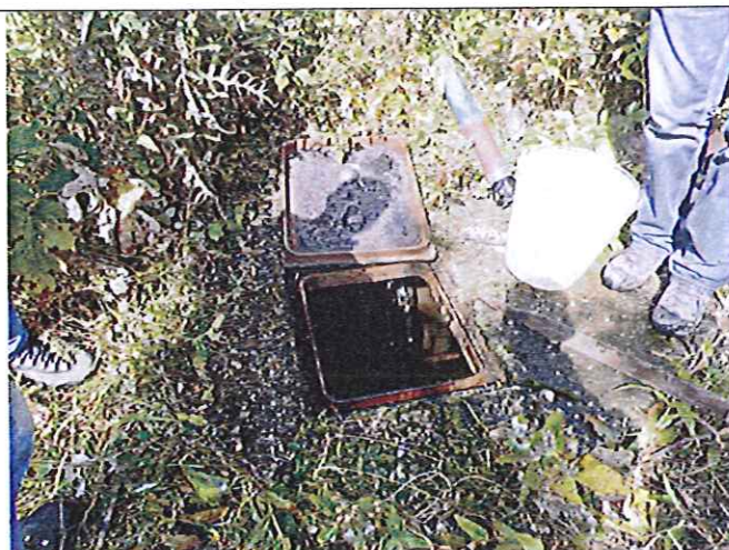
Photo 4 : Louvet, vue de l'extérieur du captage n° 4
